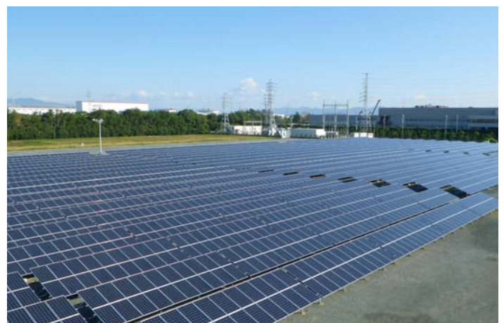
発電所のソーラーパネル
